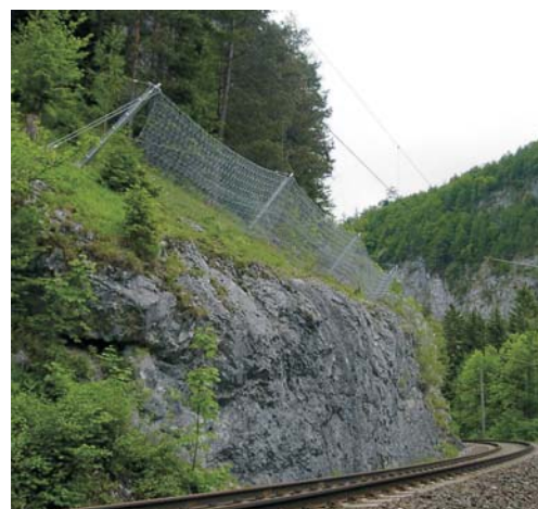
Sistema de protección contra caída de rocas usando cuerdas de retención
